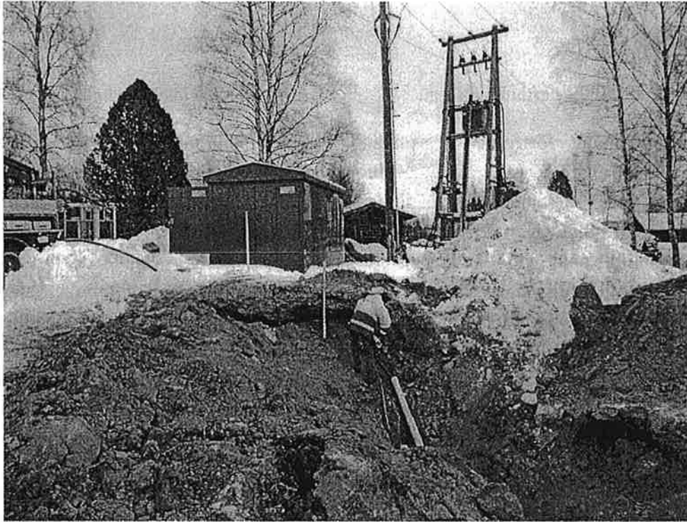
Storå transformatorstation - Muuntamo
