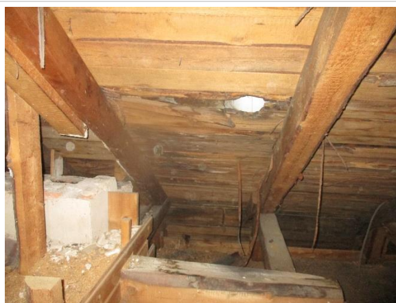
Undertrycksventil och skorsten som slutar i utrymmet
