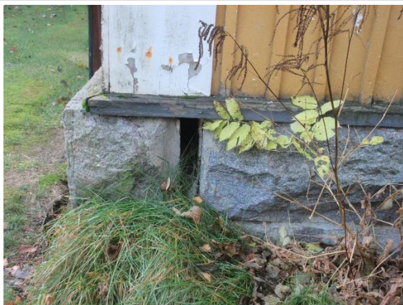
Sten som flyttat isär i ytterhörn
