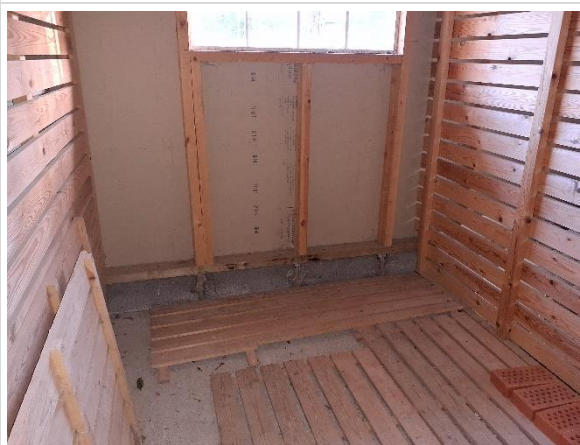
Inga skivor invändigt på ytterväggen
