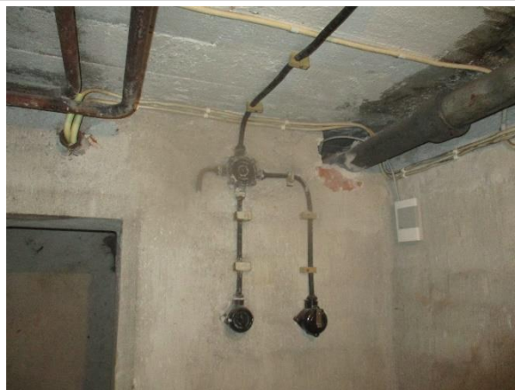
Gamla kuloledningar i källaren
