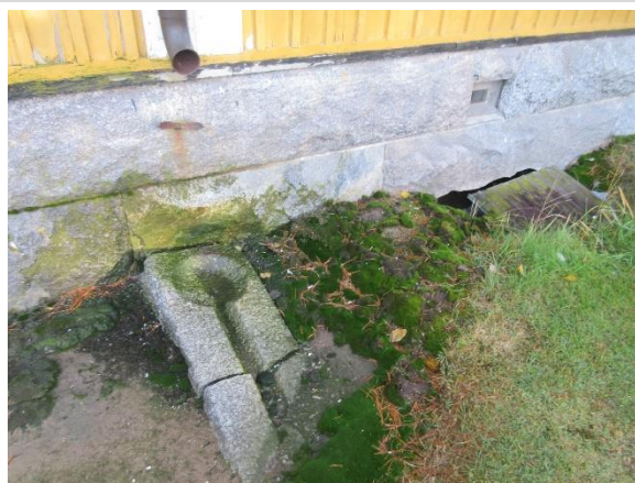
Missfärgningar pga stänk
