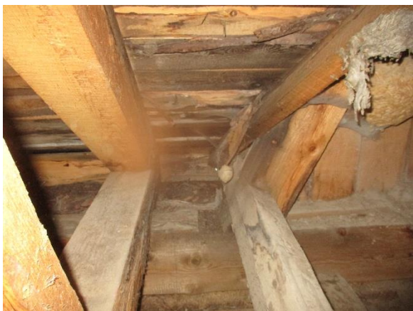
Spår av läckage vid takkant
