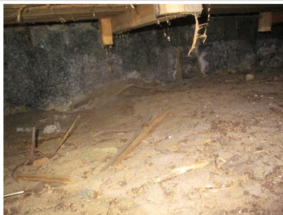
Svampväxtlighet på stenarna
