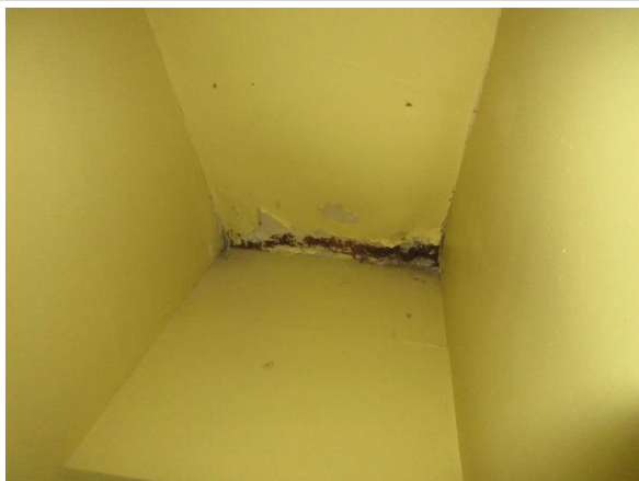
Spår av läckage i skrubbb på andra våningen
