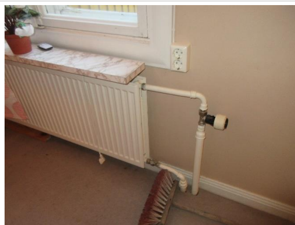
Värmerör av svartstål, radiator förnyad
