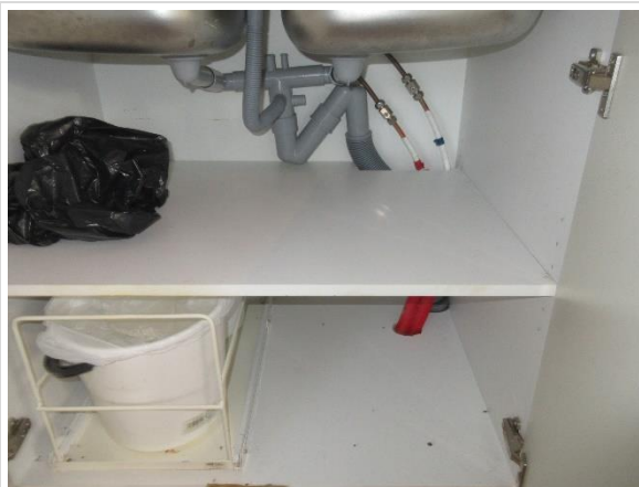
Bruksvattenrör, koppar i skyddsör
