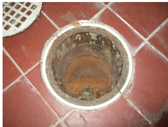
Golvbrunn i gjutjärn
