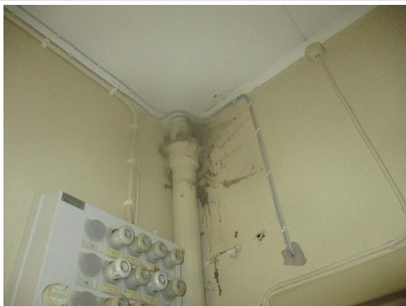
Läckage på avloppsrör
