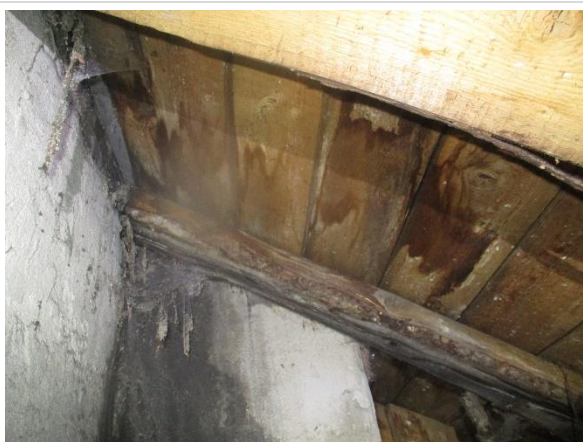
Spår av läckage kring skorsten
