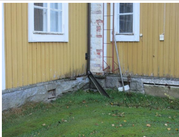
Missfärgningar på fasad
