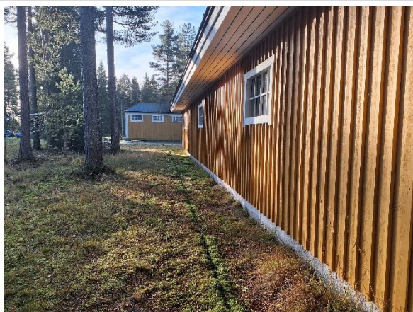
Hängränna saknas på östra sidan, spår orsakat av vatten från taket på marken
