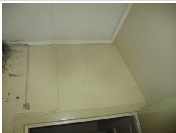
Spricka i murad vägg
