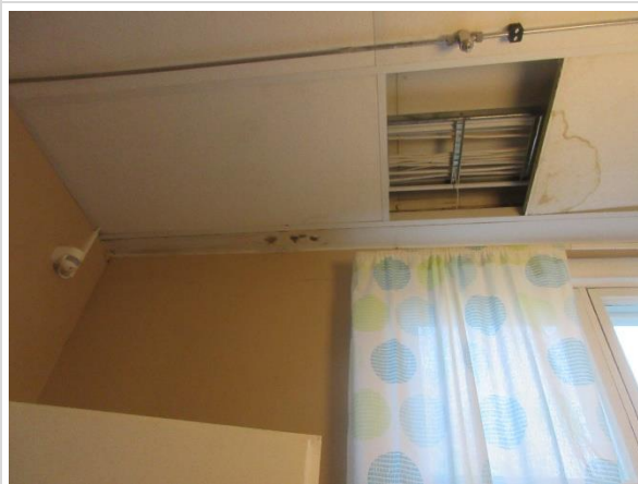
Spår av läckage på mellanbjälklag vid brandmuren
